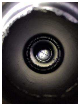
Рисунок 10 – Изображение трубы без дефектов
