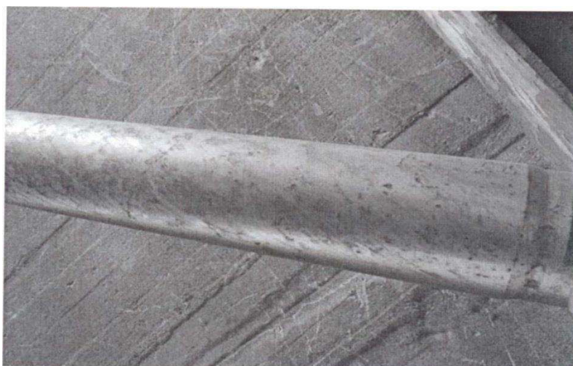
Рисунок 9.5 – Нарушение хромированного покрытия штока гидроцилиндра
