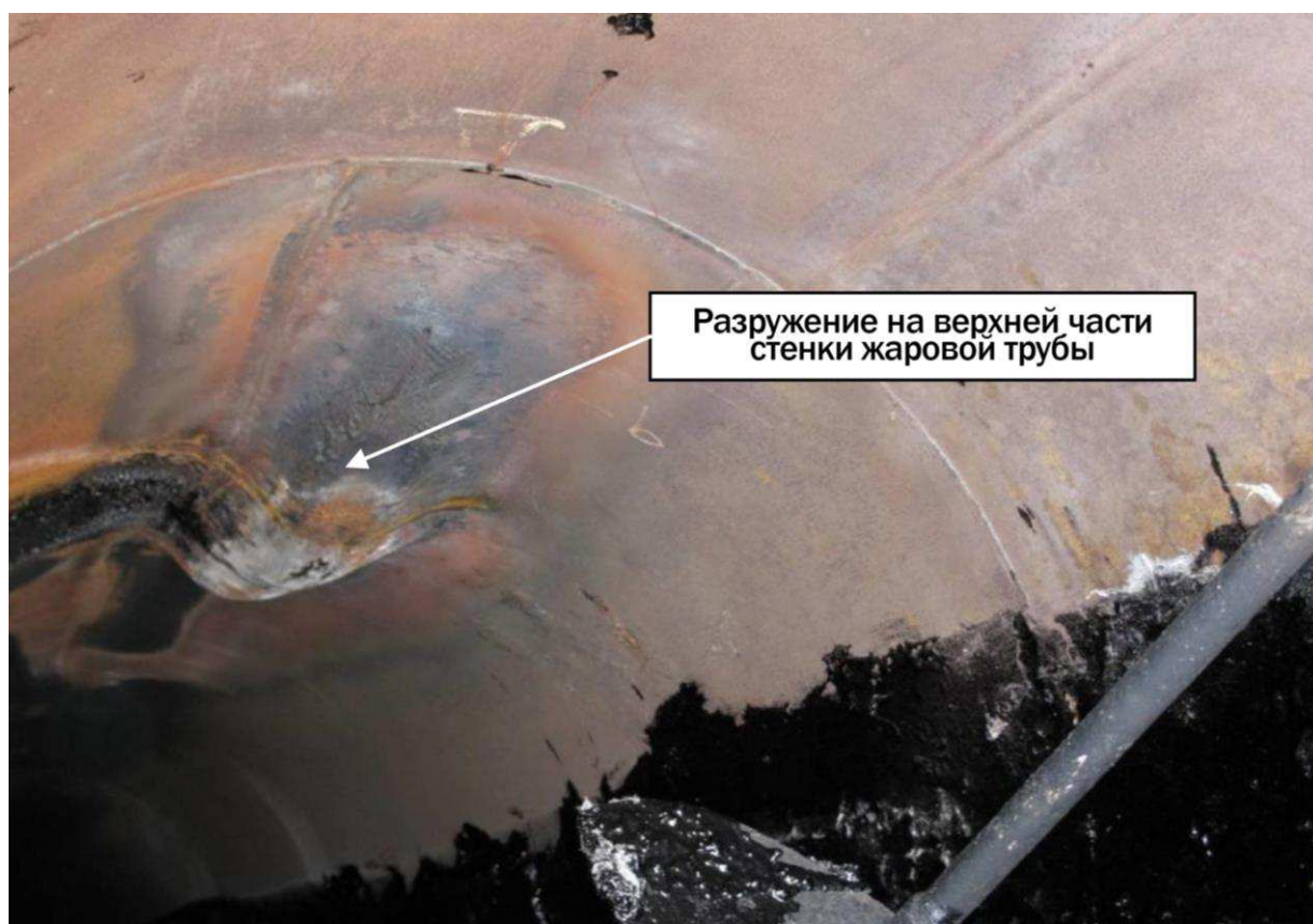
Рисунок 4.1 – Дефект жаровой трубы нефтегазоводоразделителя
