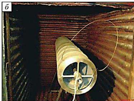
Размещение керамического конвертора в водогрейном котле КВ-Г-2,5-95
