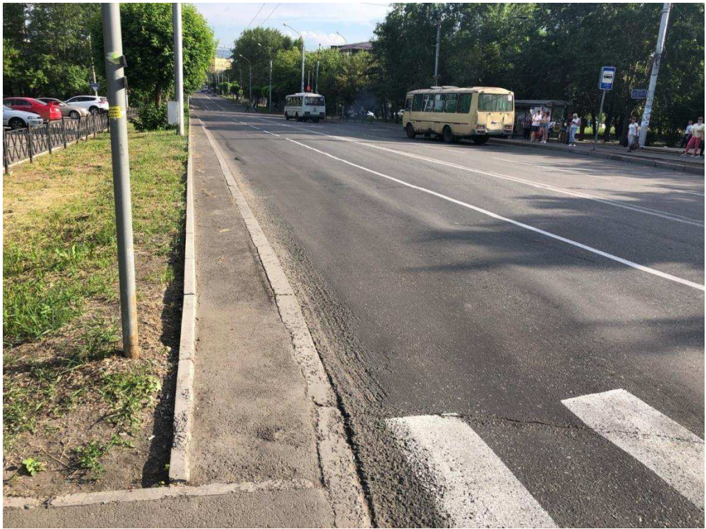
Рисунок 8– Состояние дорожного покрытия по ул. Аэровокзальная
