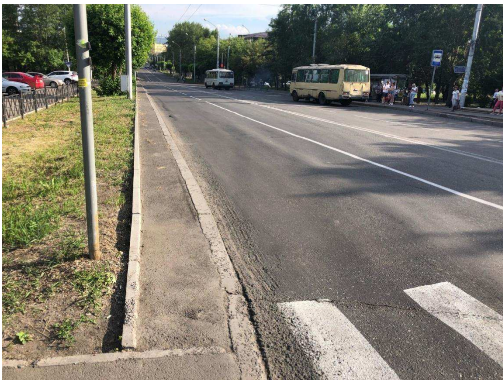
Рисунок 8– Состояние дорожного покрытия по ул. Аэровокзальная
