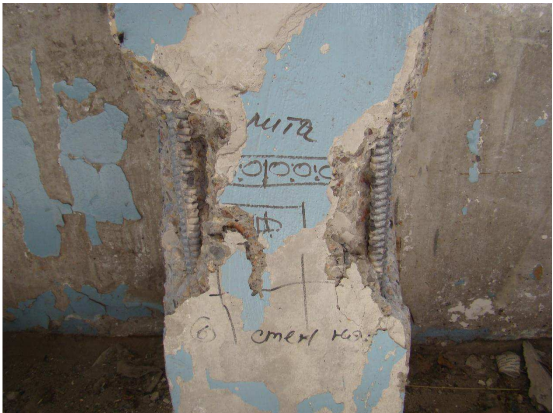
Рисунок 22 – Вскрытие арматуры железобетонной колонны на первом этаже на пересечении осей 3 и А. Крупный план.
