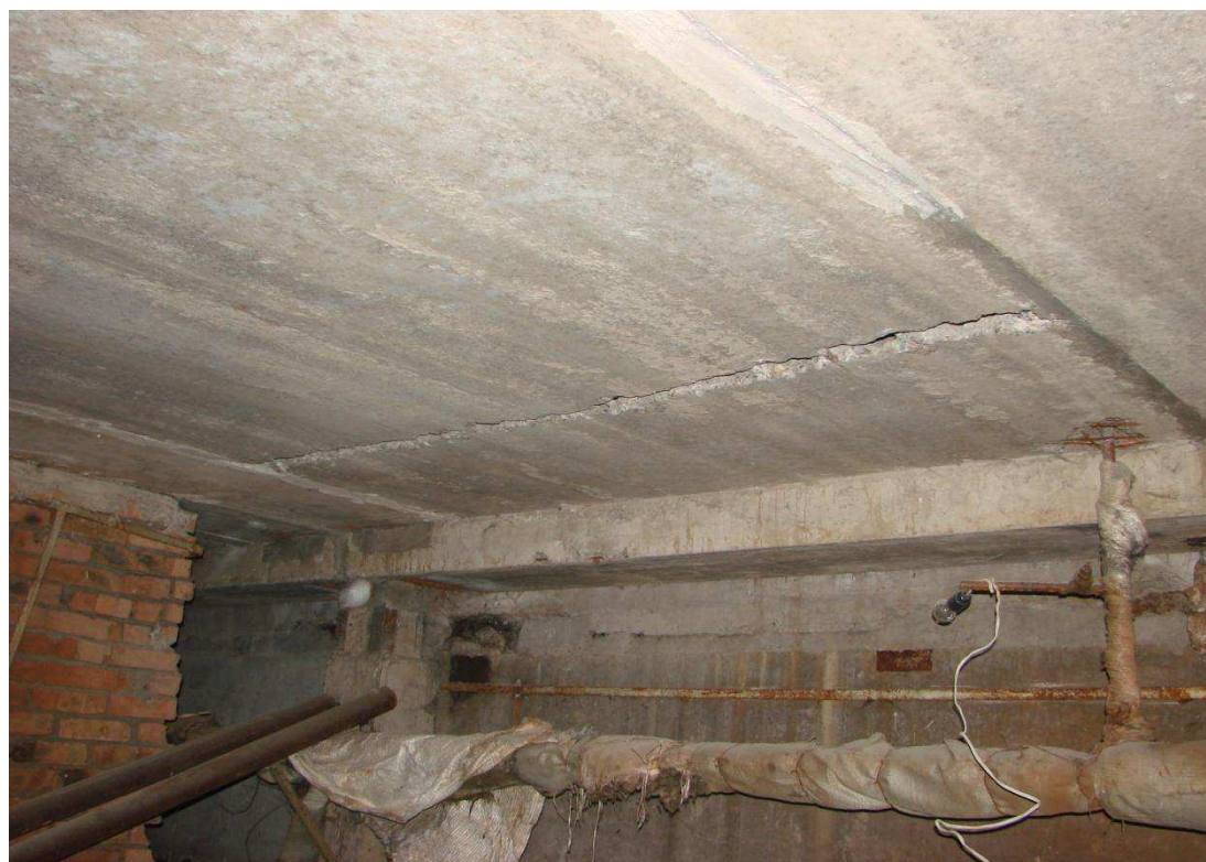
Рисунок 29 – Вскрытие плиты в подвальной части здания в осях 5-6, 1-2 для определения ее армирования
