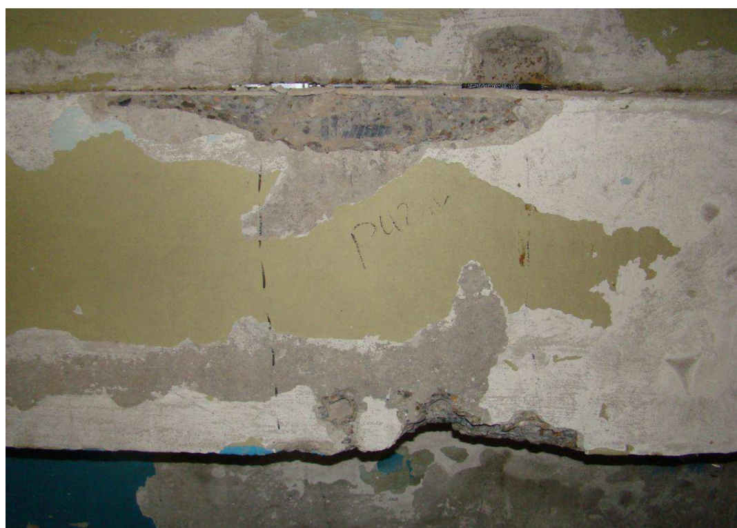
Рисунок 25 – Вскрытие арматуры ригеля по оси 1 между осями В-Г для определения его армирования. Фрагмент.
