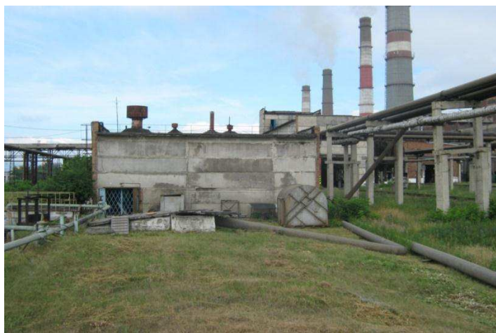
Рисунок 6 - Насосная станция промливневых вод (НПВ)
