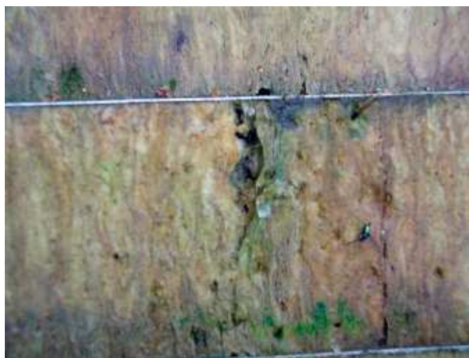
Рисунок 24 – Вид утеплителя ненадлежащего хранения
