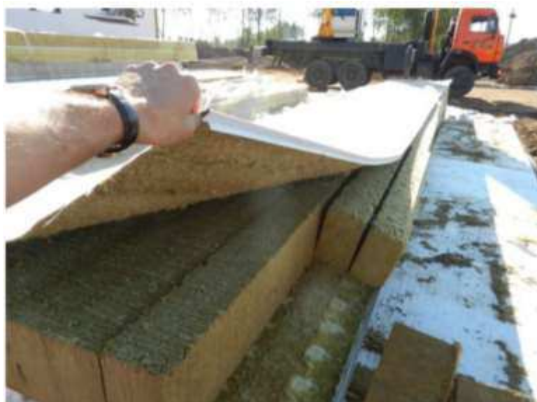
Рисунок 16 – Отслоение утеплителя от стального листа
