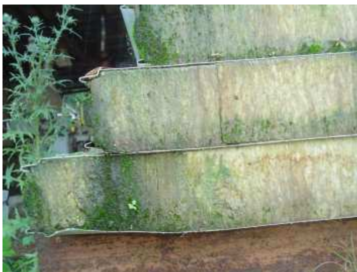
Рисунок 26- Вид утеплителя после длительного хранения при атмосферных осадках
