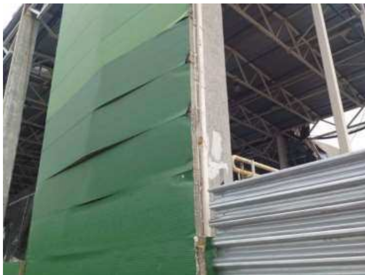
Рисунок 17 - Смятие сэндвич-панелей на опорах
