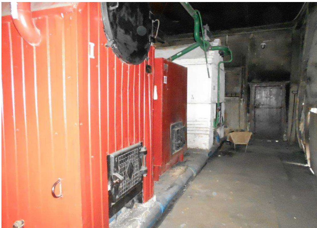
Рисунок – 13 Котельная “Тында” котлы
