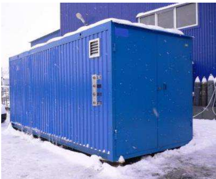
Рисунок 1.6 – Станция обезжелезивания модульного типа
