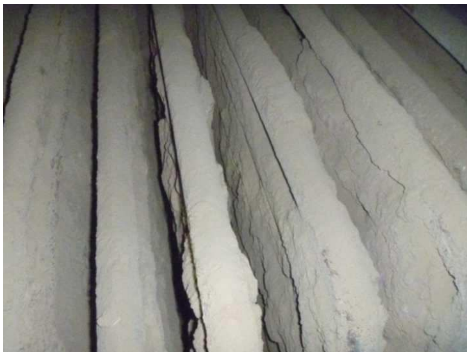
Рисунок 1.3 - Зашлакованный КПП котельного агрегата П-67 БГРЭС
