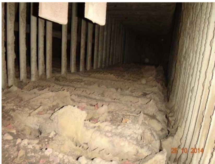
Рисунок 1.2 - Зашлакованный КПП котельного агрегата П-67 БГРЭС
