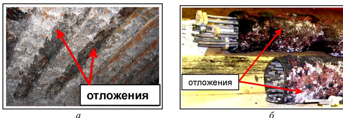
Рис. 1. Вид на подвесные ленточные электронагреватели Х20Н80-Н: а) в начале эксплуатации; б) вид поврежденного электронагревателя (фрагмент)
