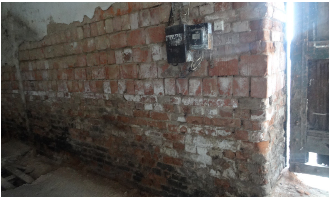
Рисунок 9– Разрушение штукатурного слоя, защитного слоя бетона. Поражение грибком кирпичной кладки стен.
