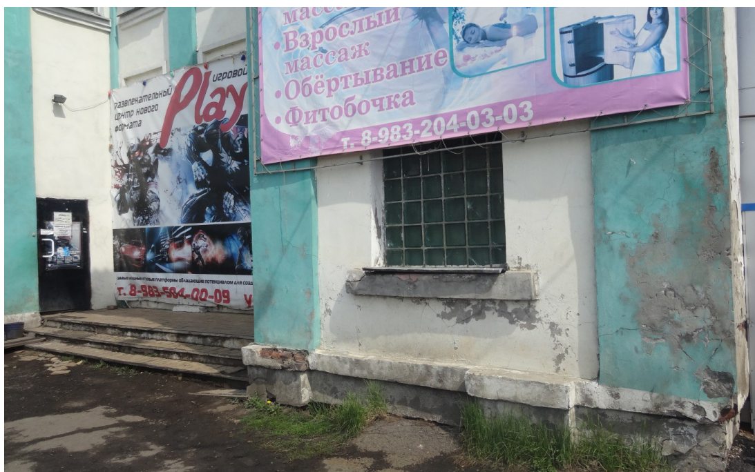
Рисунок 5 – Разрушение и замачивание кирпичной кладки цоколя, отслоение штукатурного слоя, выветривание раствора из швов кирпичной кладки. Отсутствие отмостки.
