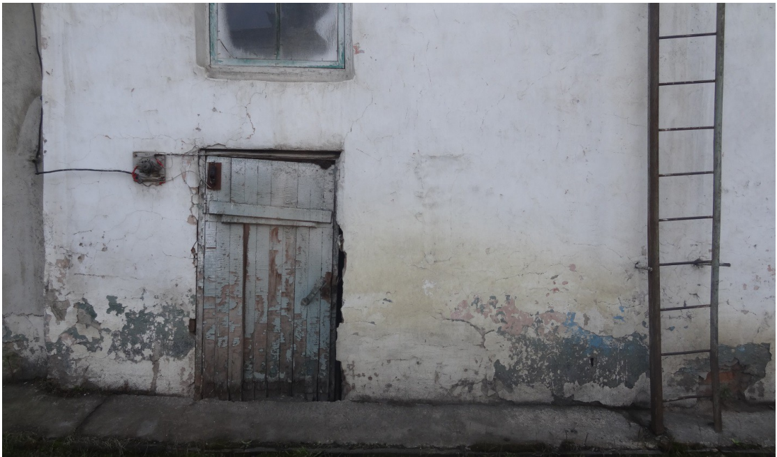
Рисунок 6 – Разрушение кирпичной кладки наружной стены в месте примыкания к дверной коробке, отслоение штукатурного слоя.
