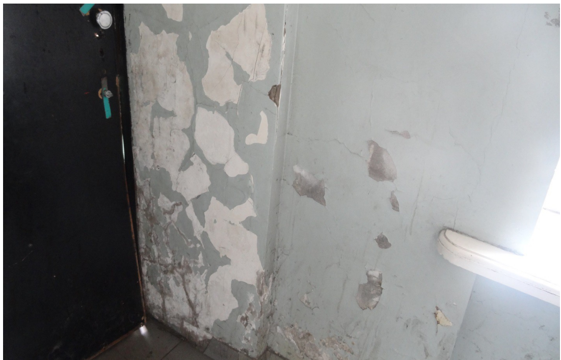
Рисунок 13 – Отслоение окрасочного слоя отделки стен.
