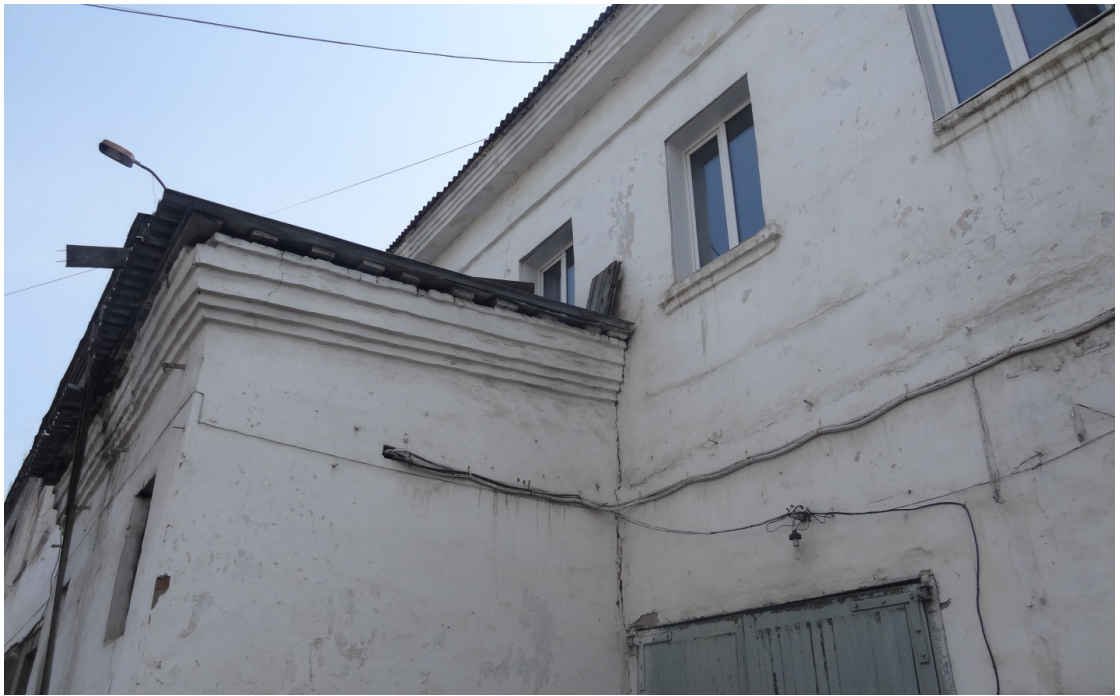
Рисунок 8 – Трещина в месте примыкания стены пристройки к стене основного блока.
