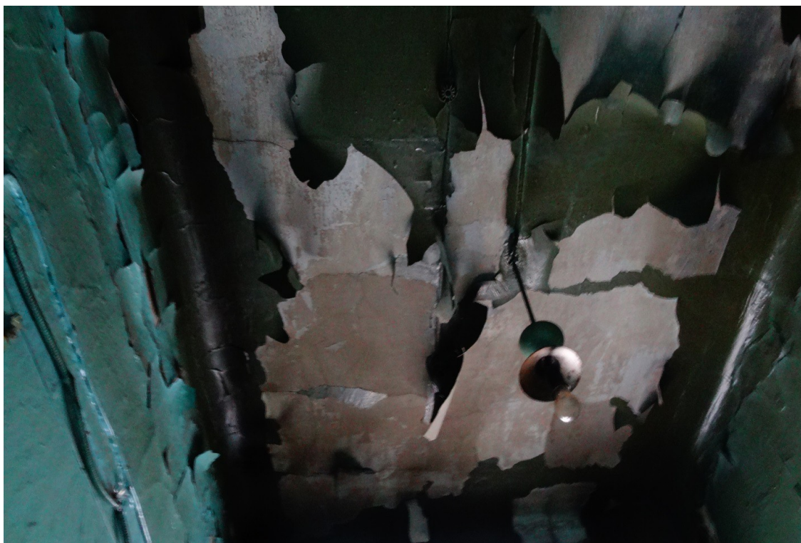
Рисунок 14 – Отслоение окрасочного слоя конструкций перекрытия (вид снизу).
