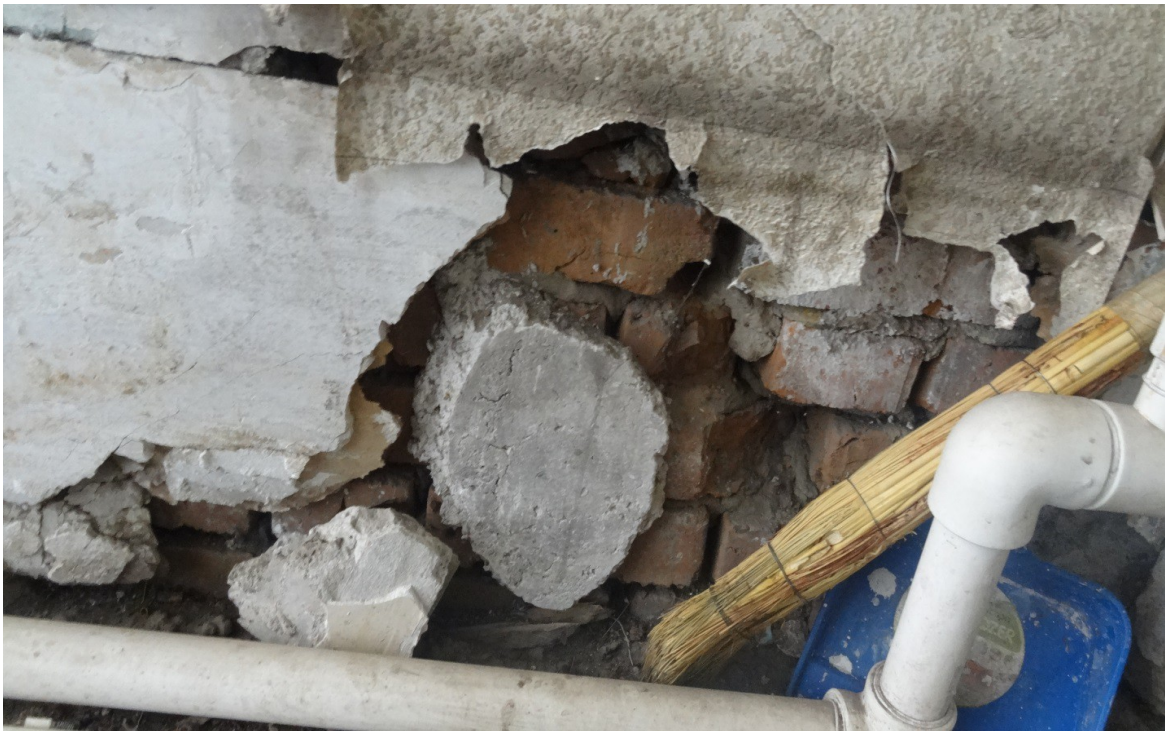
Рисунок 10 – Разрушение кирпичной кладки стен, защитного слоя бетона.
