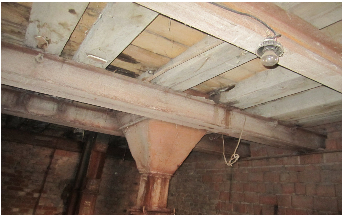
Рисунок 11 – Коррозия металлических балок, следы замачивания из-за протечек с неисправной кровли.
