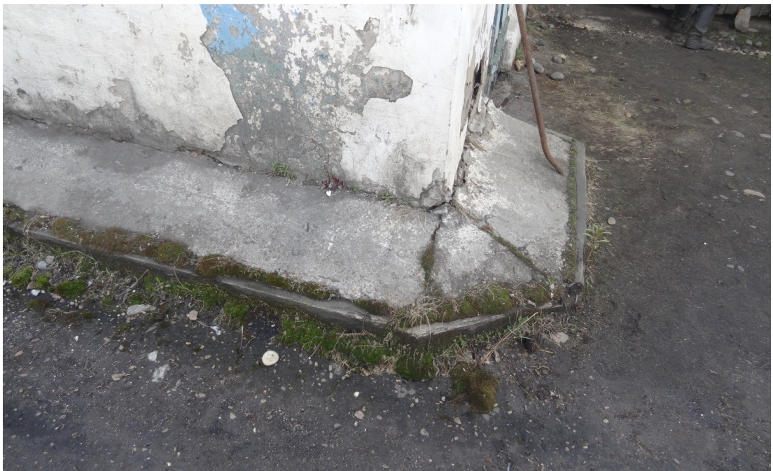
Рисунок 7 – Разрушение отмостки участками, произрастание трав, мха.
