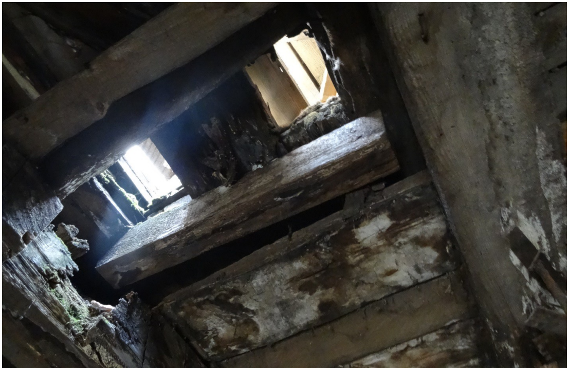
Рисунок 12 – Поражение гнилью, мхом деревянных балок конструкций покрытия в пристройке (вид снизу).
