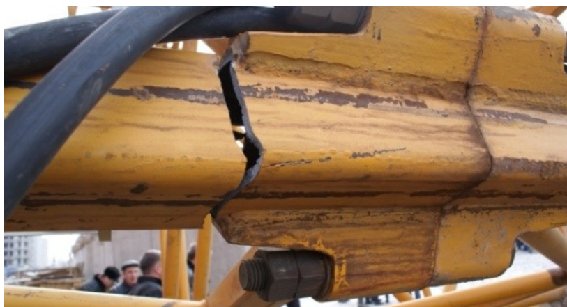
Рис. 5. Трещина в основном металле пояса
