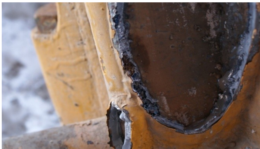
Рис. 7. Дефект сварного шва
