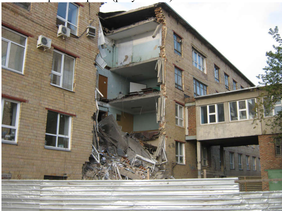
Рисунок 6.2 – Обрушенная часть правого крыла корпуса «Г»
