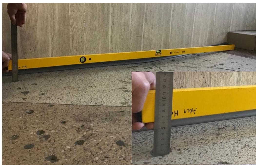
Рисунок 3.5 – Типовой дефект пола 1-го этажа; бетонные мозаичные полы по грунту в границах осей Е-Г деформированы (на снимке при накла­дывании контрольной двухметровой рейки отклонение от горизонтали составило 90 мм)
