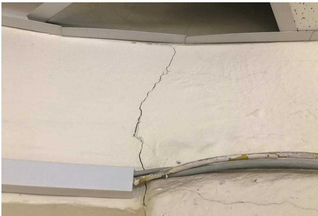
Рисунок 3.9 – Типовой дефект кирпичный колонн по оси Г: имеются вертикальные трещины в верхних частях колонн, в местах стыков балок покрытия.
