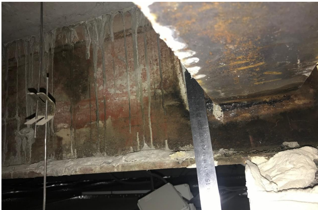
Рисунок 3.10 – Локальный дефект покрытия; в осях А-В/17-18 выполнено монолитное железобетонное перекрытие по стальным балкам; балки не имеют защитного покрытия.
