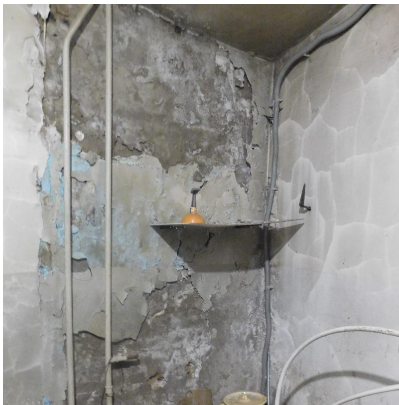
Рисунок 3.6 – Типовой, массовый дефект внутренней отделки: происходит отпадение окрасочного и штукатурного слоёв наружных стен подвала
