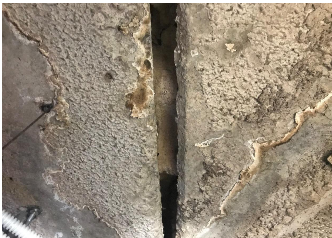
Рисунок 3.11 – Локальный дефект покрытия в осях А-В/15-17; плиты перекрытия длительное время подвергались замачиванию в результате чего образовались отдельные трещины раскрытием до 2 мм, выпал раствор между плитами, на нижней поверхности образовались солевые отложения и наросты.
