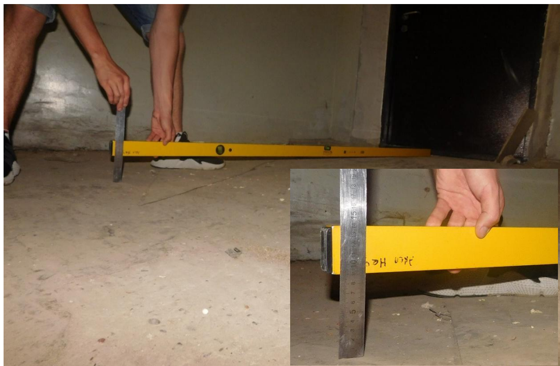
Рисунок 3.4 – Типовой, массовый (30% от площади подвала) дефект ненесущих конструкций: бетонные полы по грунту в подвале деформированы: при накла­дывании контрольной двухметровой рейки отклонение от горизонтали составило 90 мм
