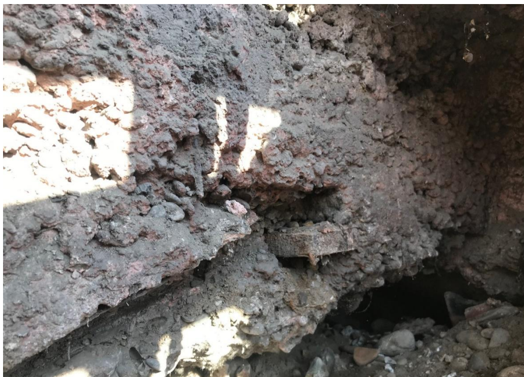
Рисунок 3.2 – Совместно с рис. 3.1; вид ростверка сбоку: бетонные работы выполнялись не качественно, уплотнение смеси не проводилось; в качестве заполнителя применены окатанные частицы (гравий и мелкая галька)
