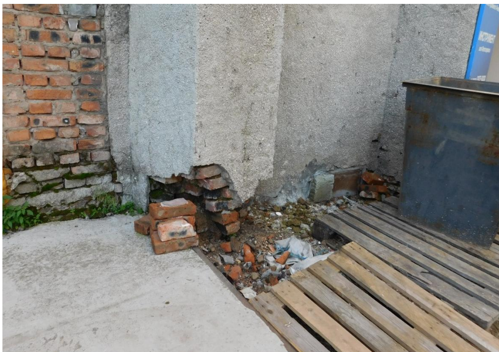
Рисунок 3.7 – Типовой, локальный дефект кирпичной кладки: в цокольной части пилястр в осях М-2,3 в уровне земли, происходит деструкция кладки на высоту до 50 см
