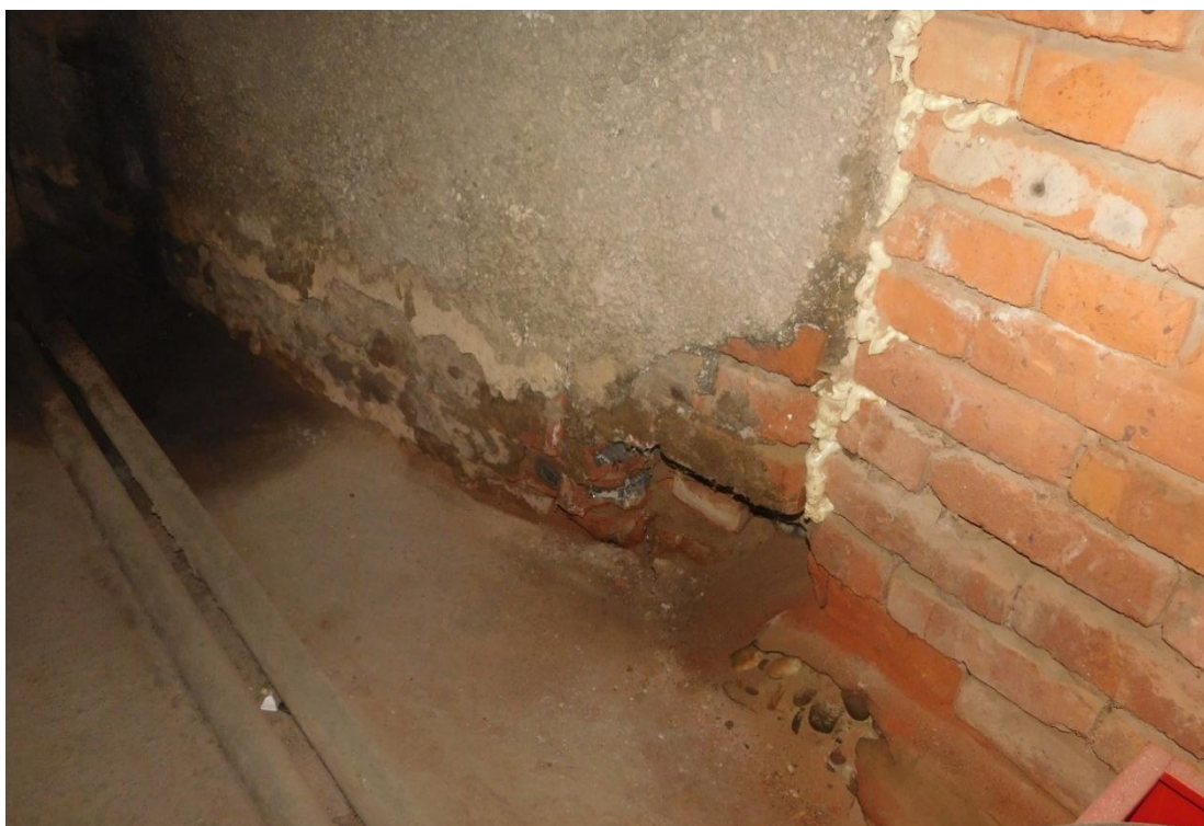
Рисунок 3.8 – Типовой, локальный дефект кирпичной кладки: в цокольной части стены в осях 3-М в уровне пола, происходит деструкция кладки на высоту до 40 см
