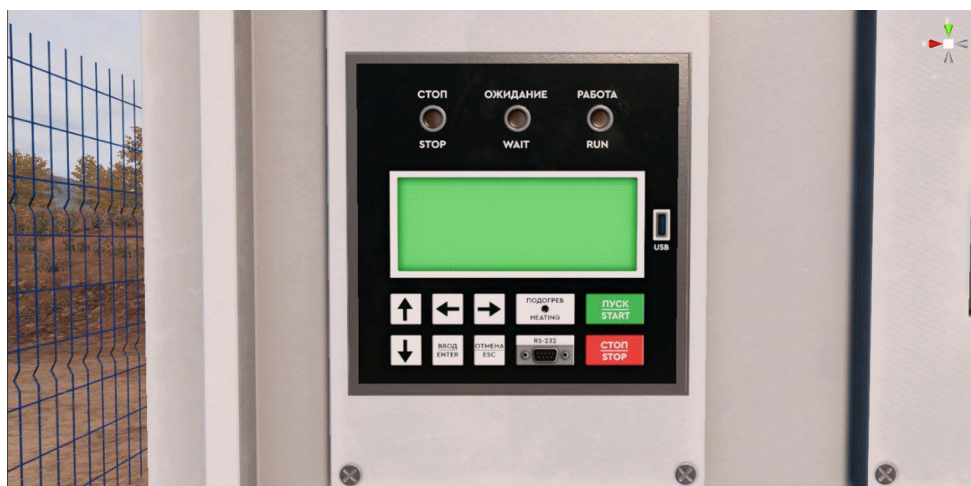
Рис. 2. Панель станции управления
