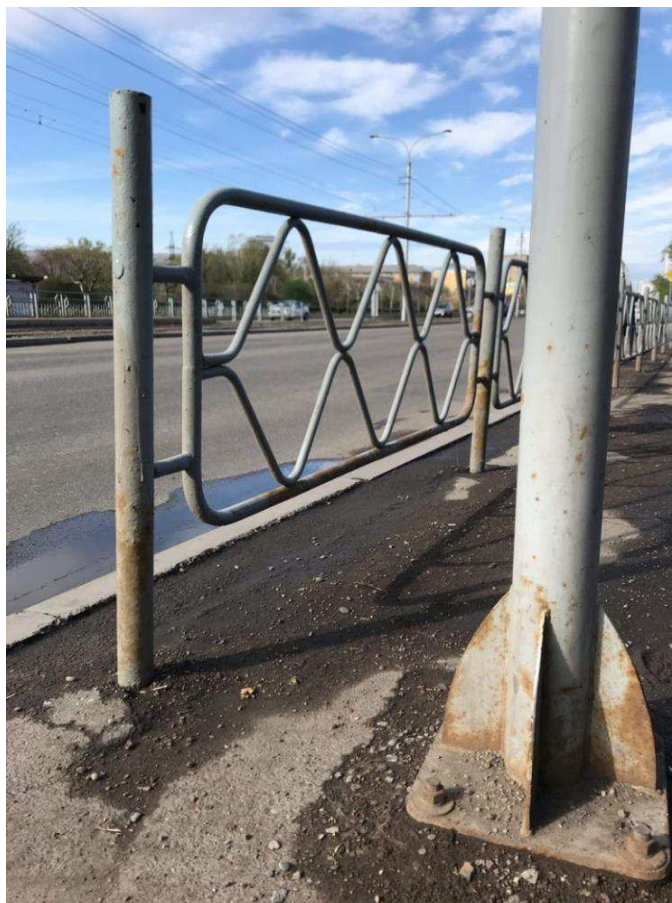
Рисунок 28 – Коррозия металлических сооружений дорожной части
