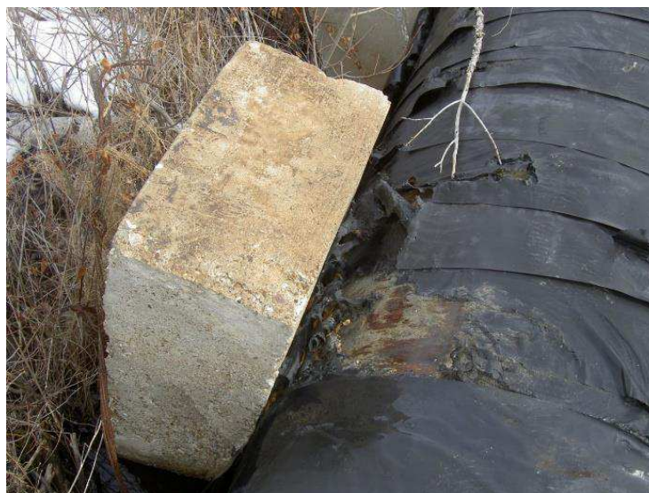
Рисунок 5 – Повреждение антикоррозионного покрытия газопровода [1]
