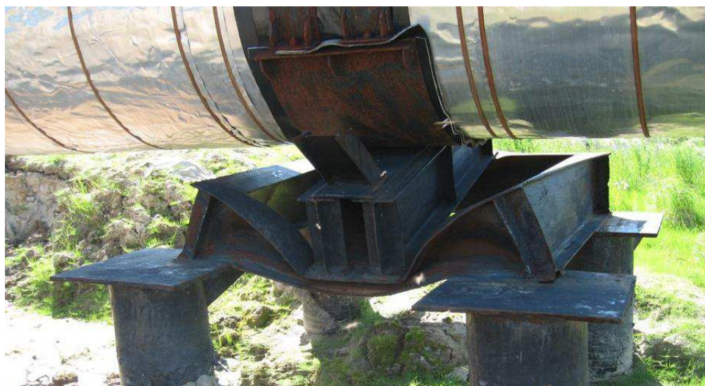
Рисунок 6 – Повреждение надземной опоры газопровода диаметром 720 мм [1]
