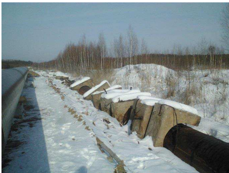
Рисунок 4 – Смещение утяжелителей трубопровода морозным пучением [1]
