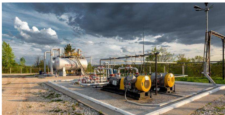
Рисунок 3 – Дожимная насосная станция
