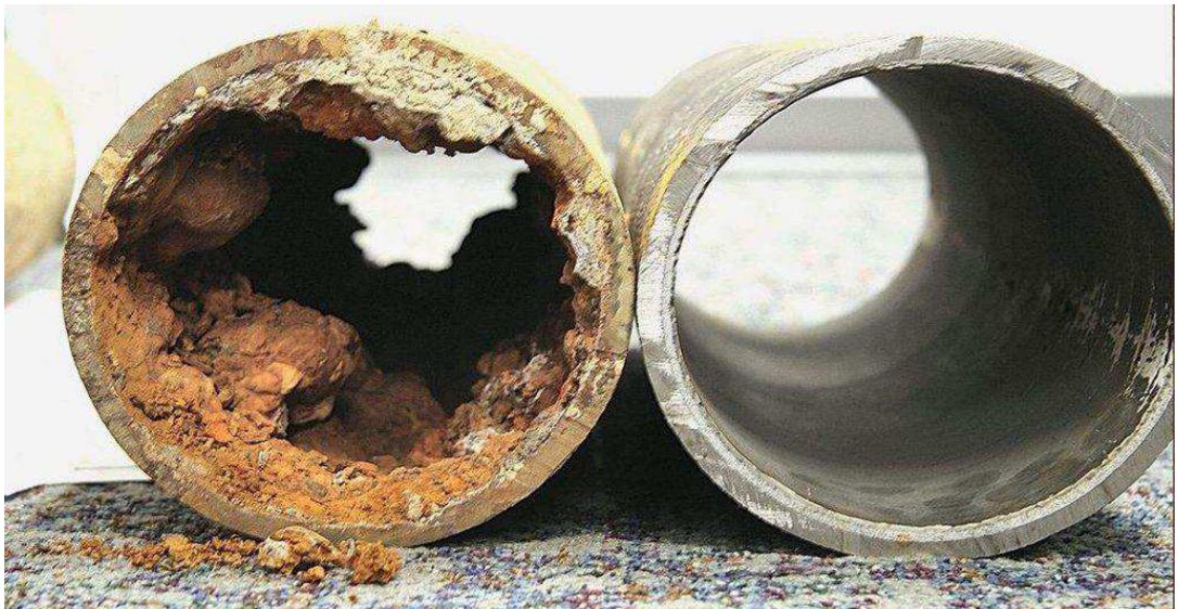
Рисунок 7 – Внутренняя коррозия трубопровода
