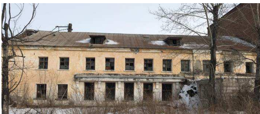
Рисунок 9 - Общий вид административно-бытового корпуса гидролизного завода в п. Усть-Абакан в настоящее время
