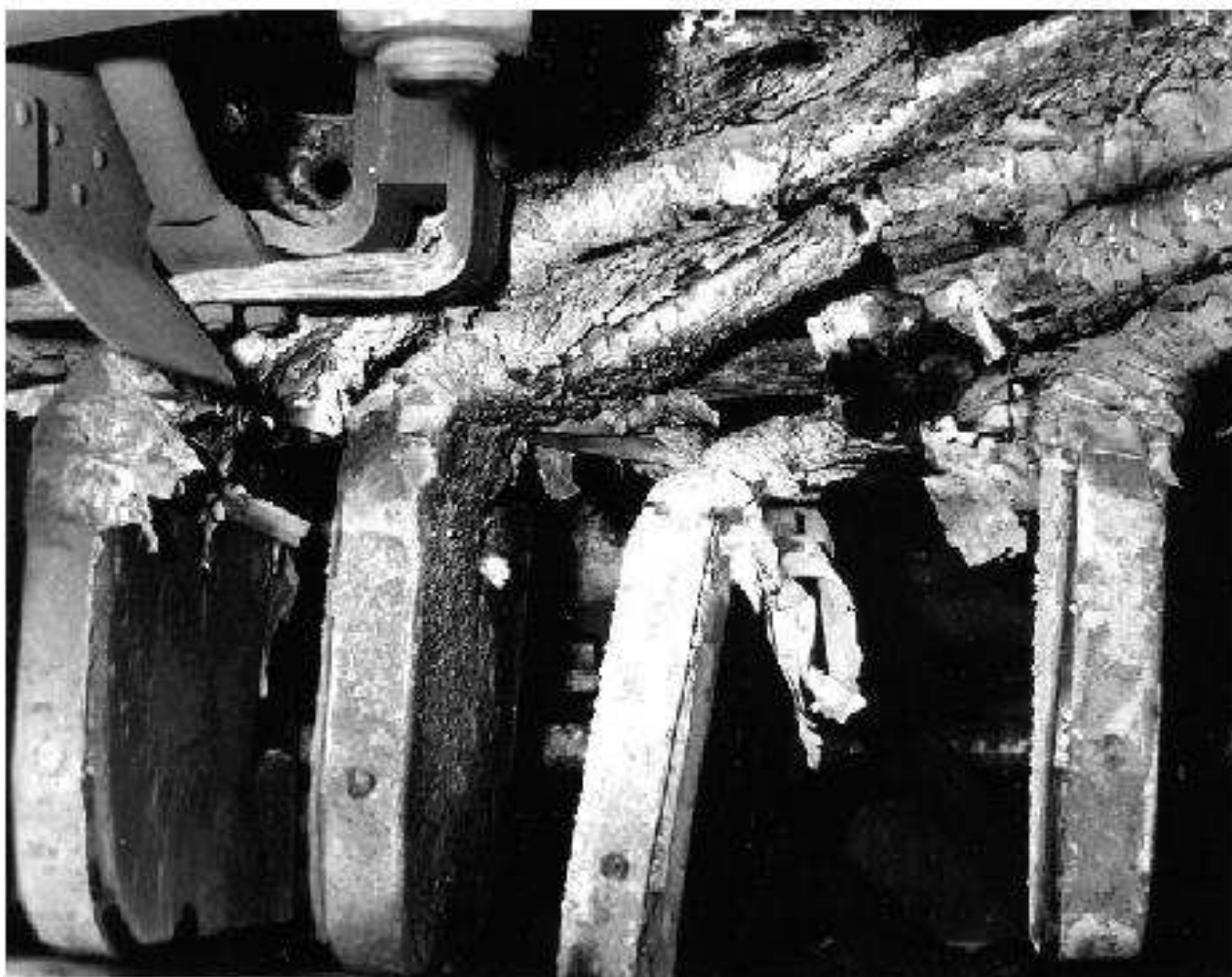
Рисунок 9.1 – Разрушение нижних лобовых частей обмотки статора в результате междуфазного короткого замыкания
