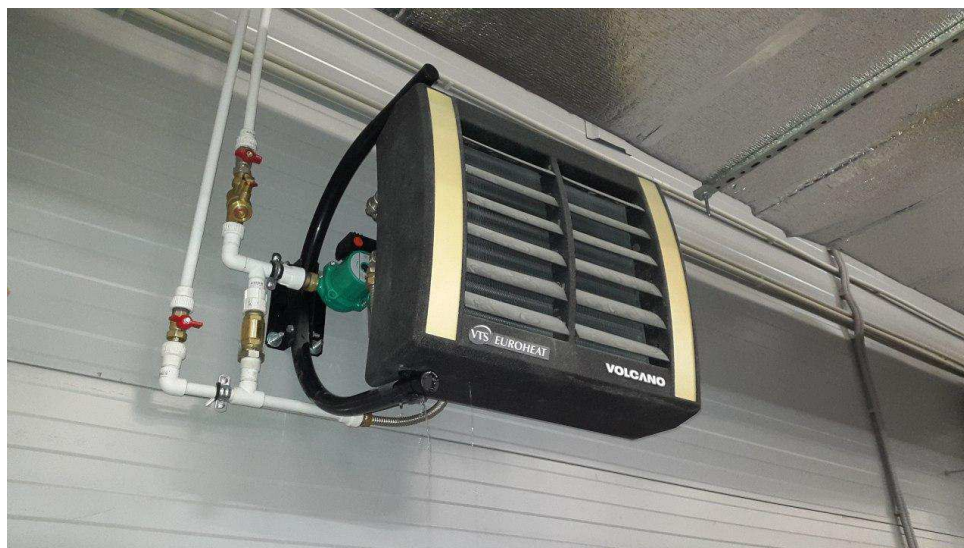
Рисунок 2.2 – Система Волкано тепловентиляторов
