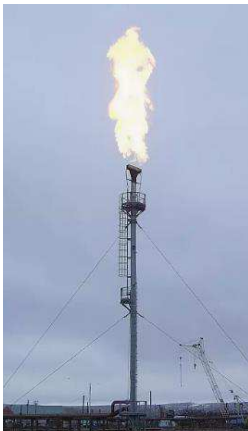
Рисунок 1 – Факельная установка открытого типа
