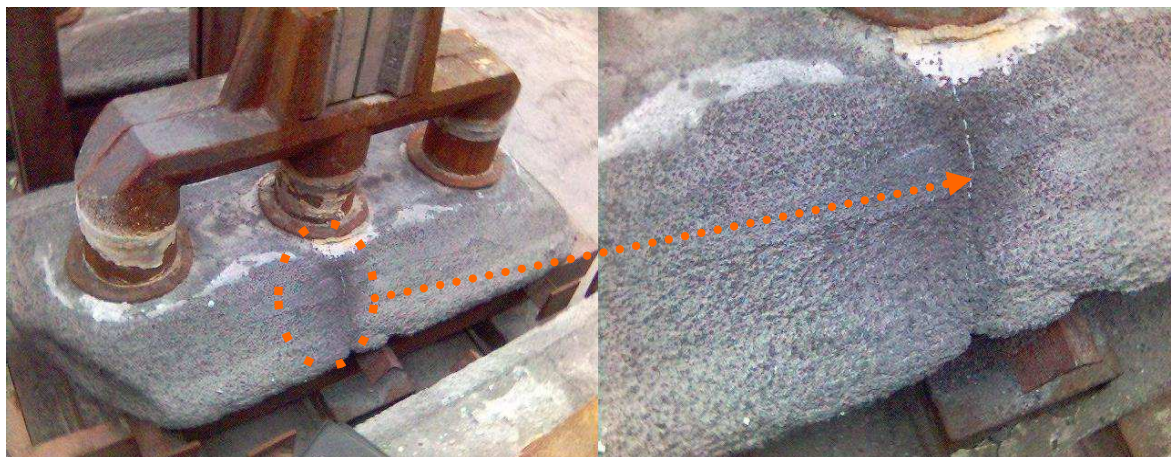
Рисунок 2 – Поперечная трещина огарка
