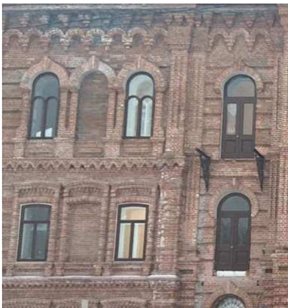
Рис. 1 Появление первых высолов (левая часть главного фасада)
