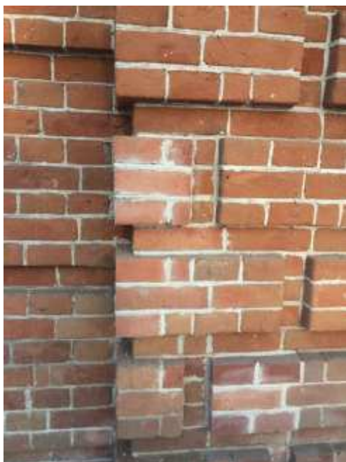
Рис. 5 участок кладки с нарушением толщины шва, также видно попадание раствора на кирпич
