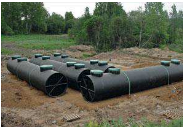
Рис. 2.1.1. Автономные очистные сооружения
