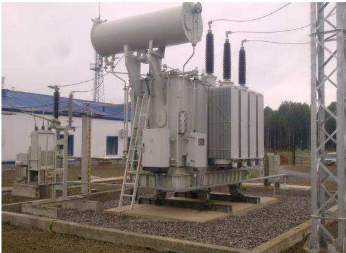
Рисунок 8 – Маслоприемник силового трансформатора
