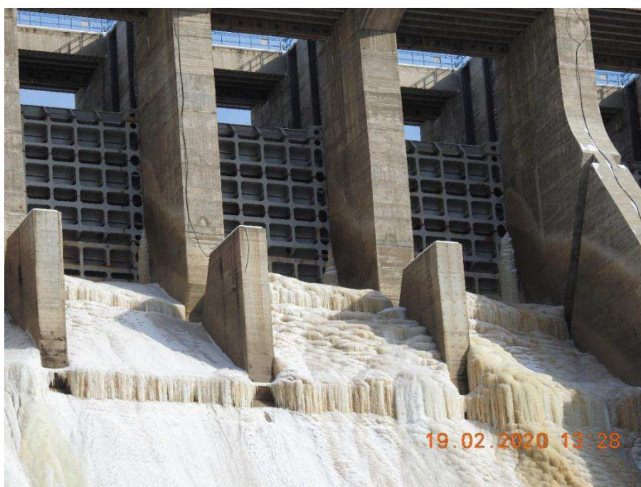
Рисунок 4.1 – Образование льда на эксплуатационном водосбросе
