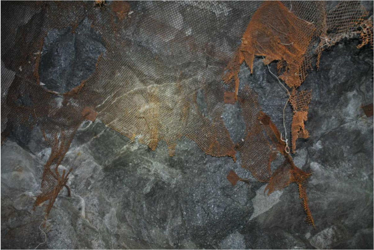
Фото 9.1. Анкерная крепь свода. Металлическая сетка оборвана
