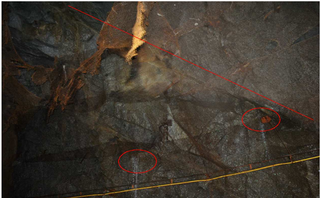
Фото 9.6. Высачивание воды через тектонические трещины в правой стенке подходной выработки в виде свищей (ПК0+72,50 м)
