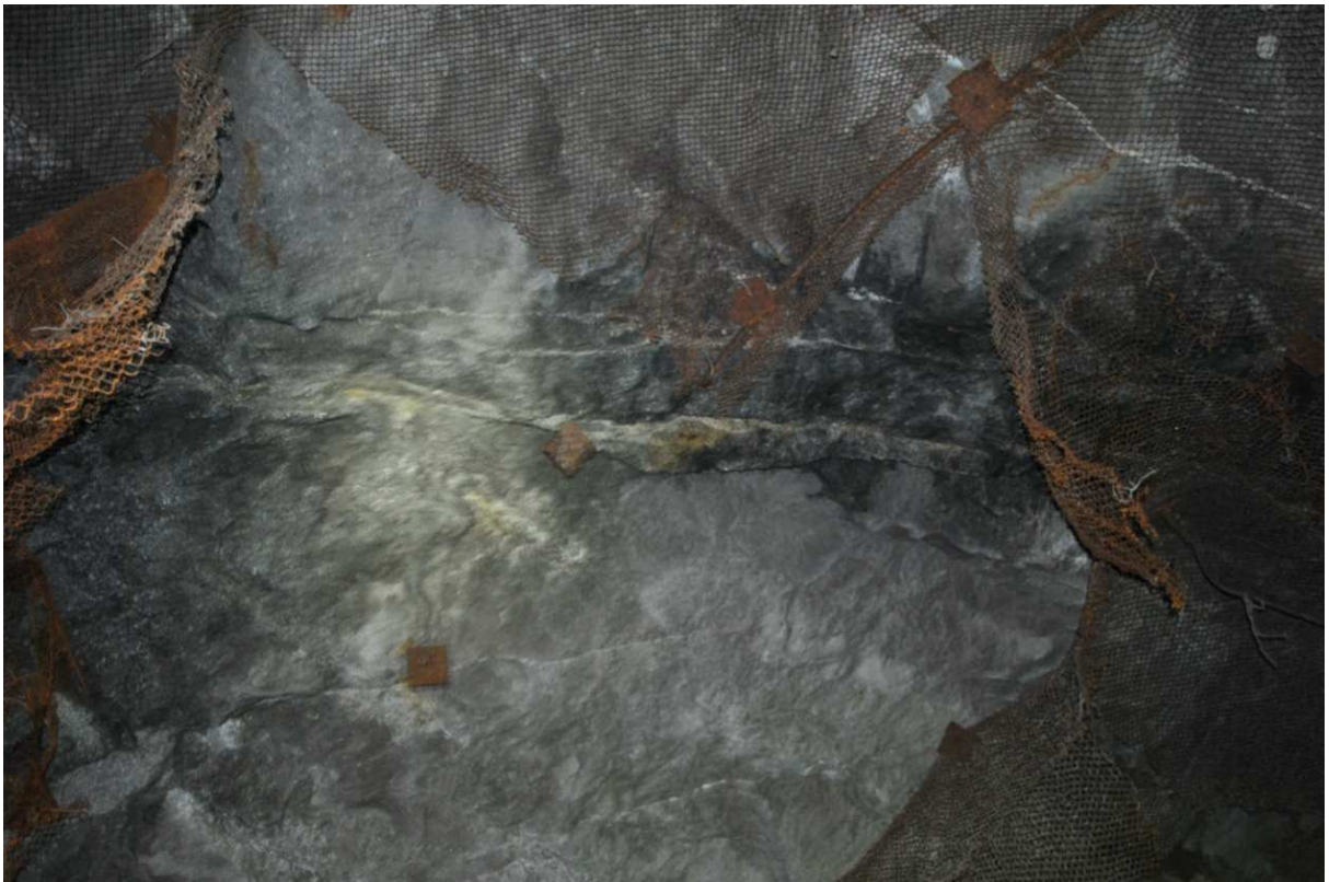
Фото 9.2. Тектоническая трещина. Анкерная крепь, металлическая сетка, усиление арматурой
