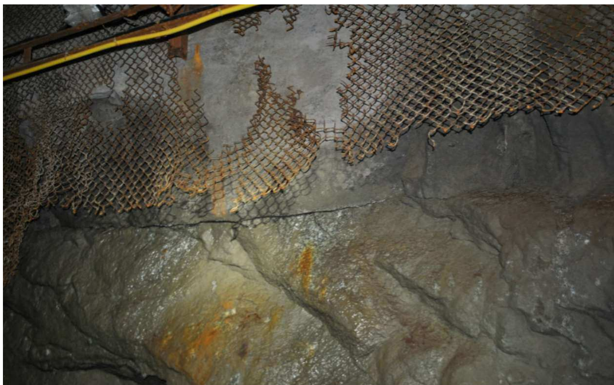
Фото 9.4. Горизонтальная трещина с высачиванием воды в стенке выработки (ПК1+50,0, левая стенка)
