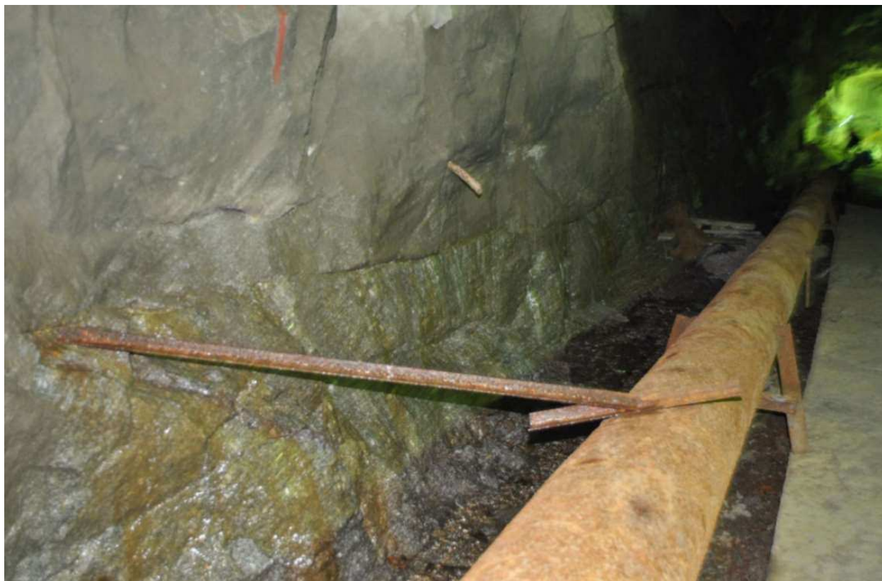
Фото 9.3. Трубопровод водоотлива d=325 мм. Высачивание воды из горизонтальной тектонической трещины (ПК1+70,0, левая стенка)
