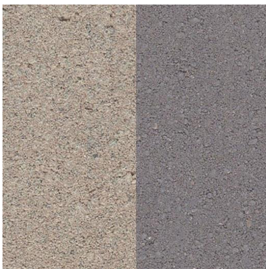
Рисунок 7 – Поверхность бетона на белом цементе (слева) и сером цементе (справа) без добавления пигмента
