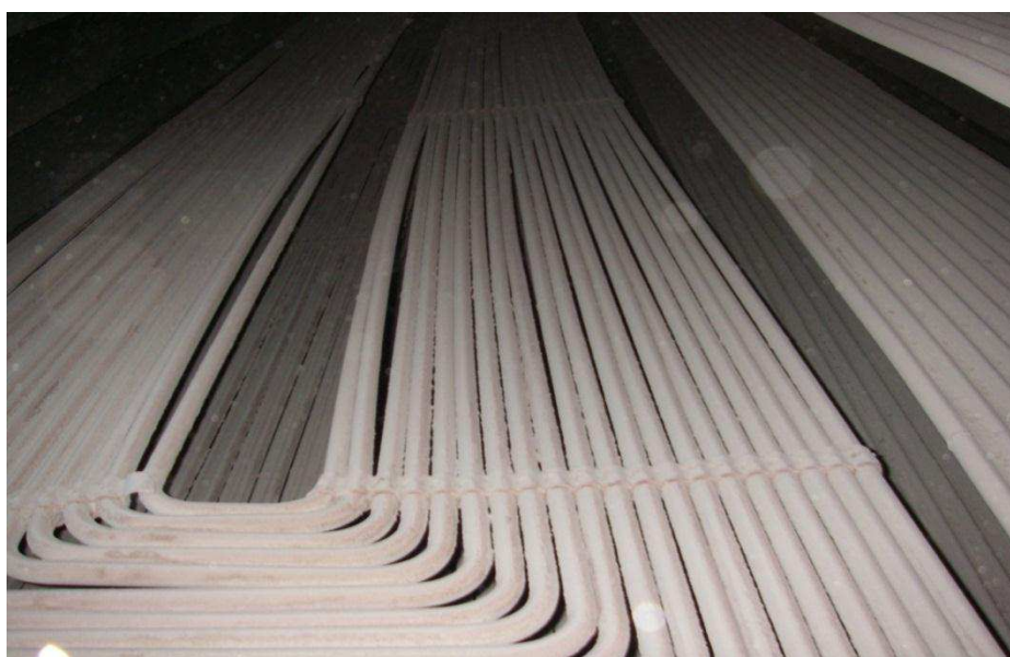
Рисунок 2.1 – Ширмовые поверхности нагрева котла П-67 БГРЭС
