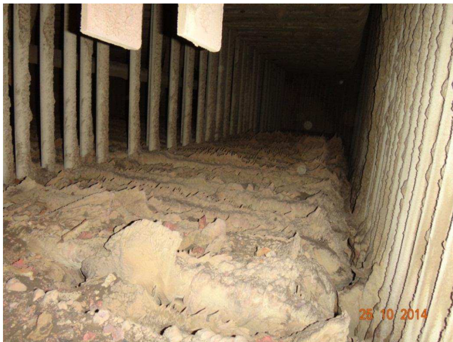
Рисунок 1.2 – Зашлакованный КПП котельного агрегата П-67 БГРЭС
