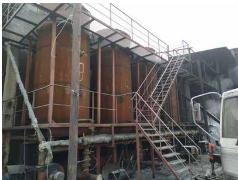
Рис. 4. Газогенераторы в г.Черногорске
