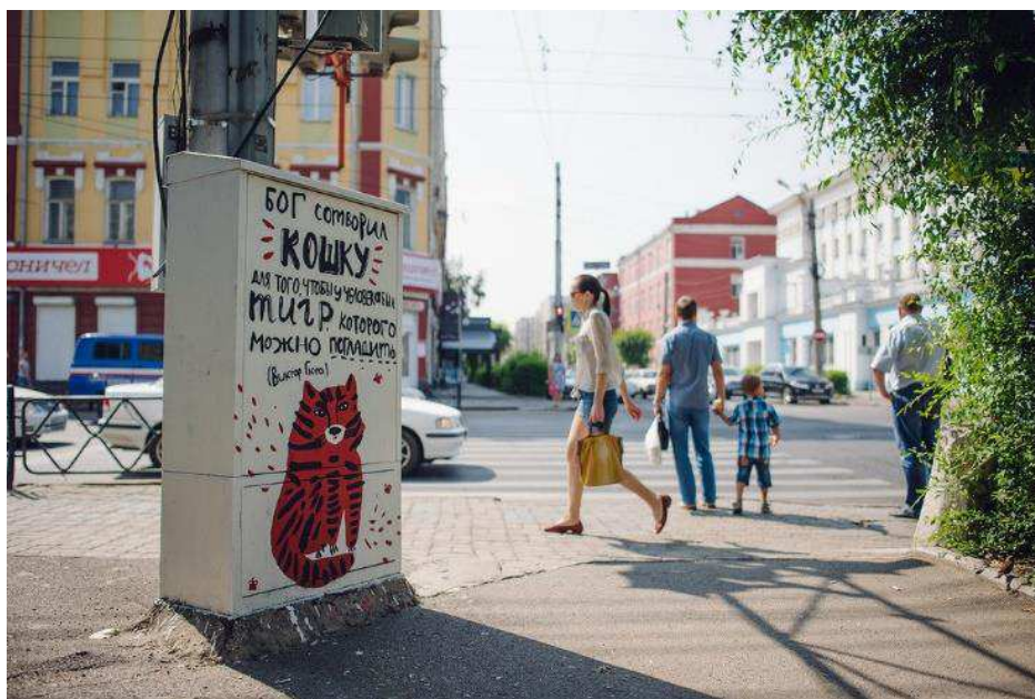
Рисунок Г.15. Коммутационный шкаф в центре города. – общий вид.
