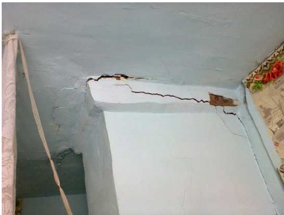
Рисунок 5 – Деформации деревянного перекрытия в области печной трубы
