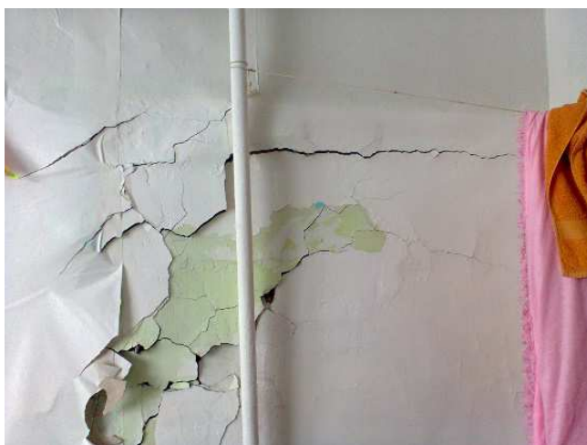
Рисунок 7 – Отслаивание штукатурного и лакокрасочного слоя стен дома
