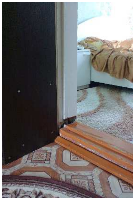
Рисунок 6 – Деформации дверного проема
