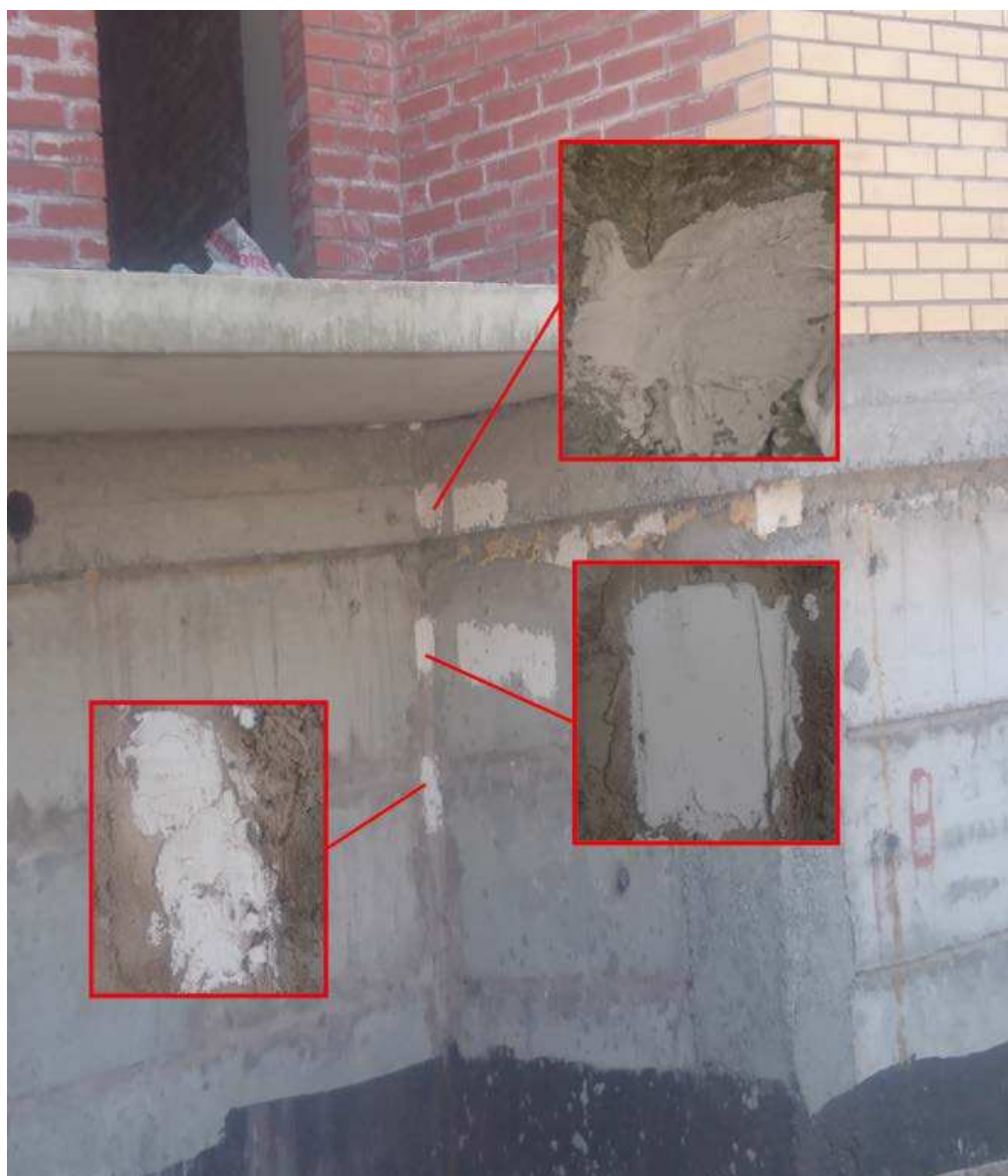
Рисунок 57 – Обследование монолитного фундамента на динамику раскрытия трещины.
