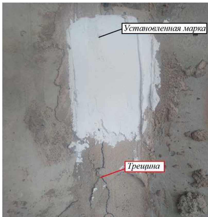
Рисунок 50 – Оценка состояния установленных марки №2.
