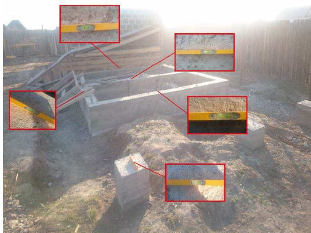
Рисунок 56 – Обследование монолитного ростверка на наличие возможных деформаций.
