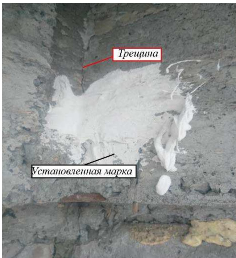
Рисунок 49 – Оценка состояния установленных марки №1.
