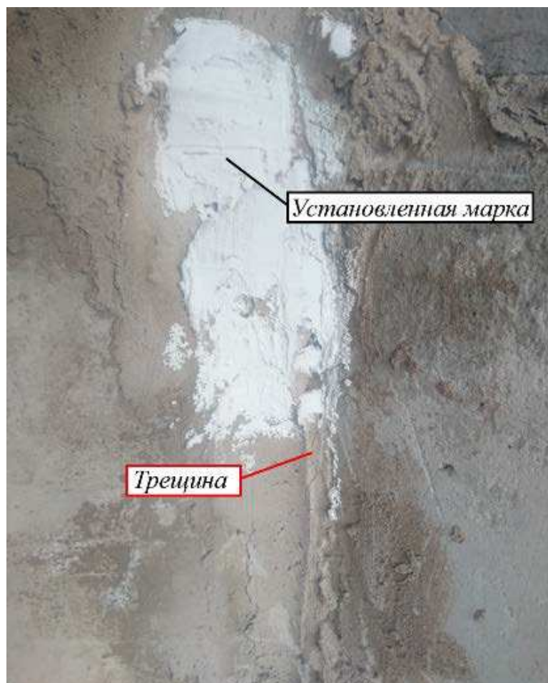
Рисунок 51 – Оценка состояния установленных марки №3.
