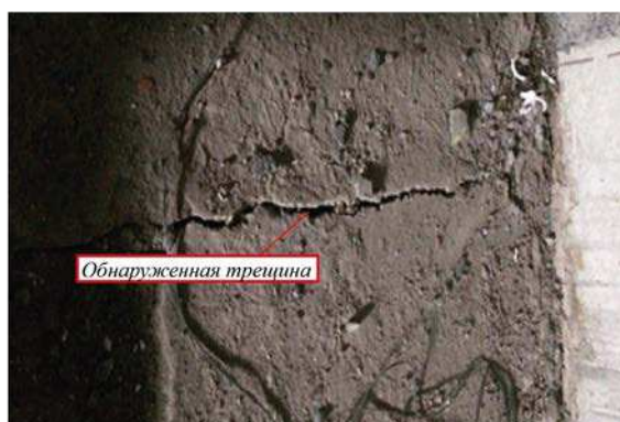
Рисунок 46 – Трещина в фундаментном основании с внутренней части блок – секции.
