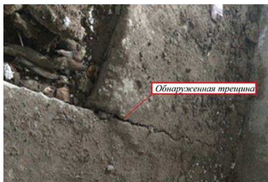
Рисунок 45 – Образование трещин в фундаментном основании с внутренней части блок – секций
