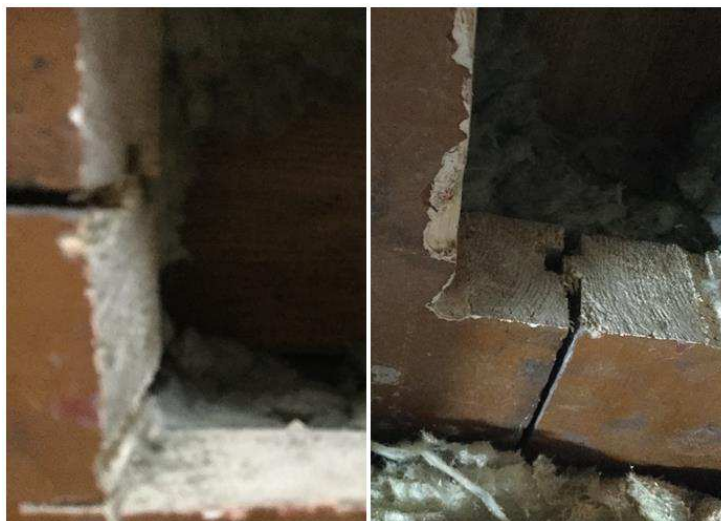
Рисунок 7 – Наличие щелей и зазоров между настилом из шпунтовых досок.
