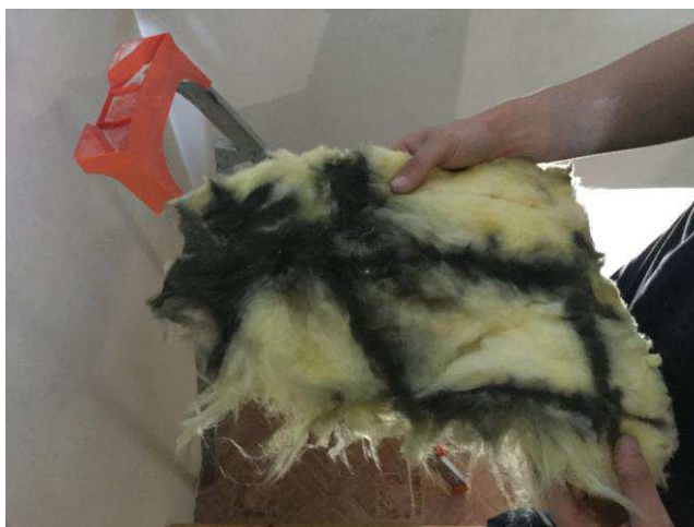
Рисунок 5 – Наличие пылеватых отложений в утеплителе.
