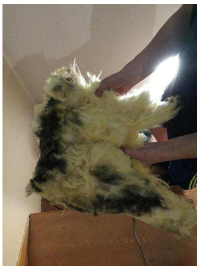
Рисунок 8 – Пылевые отложения в утеплителе в области бруса-мауэрлата.
