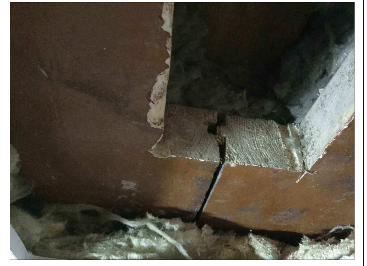
Наличие щелей и зазоров между настилом из шпунтовых досок.
