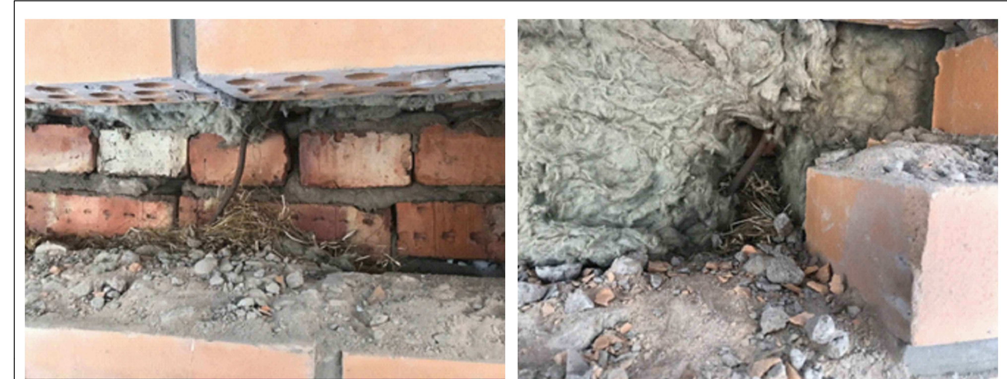
Дефекты кладки и теплоизолирующего слоя.
