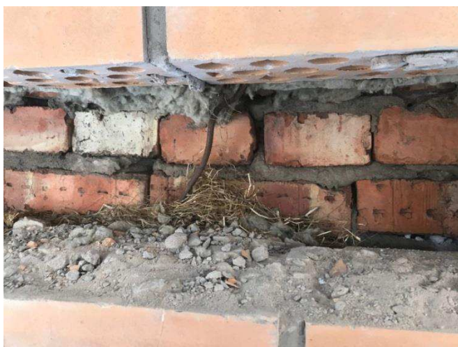
Рисунок 13 – Дефекты в кладке в виде неоднородности раствора и щелей.
