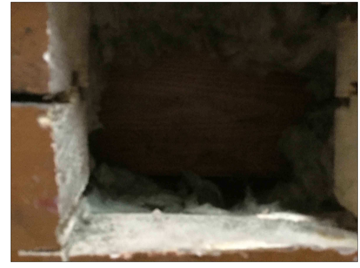
Наличие щелей и зазоров между первичным настилом из дюймовой доски.
