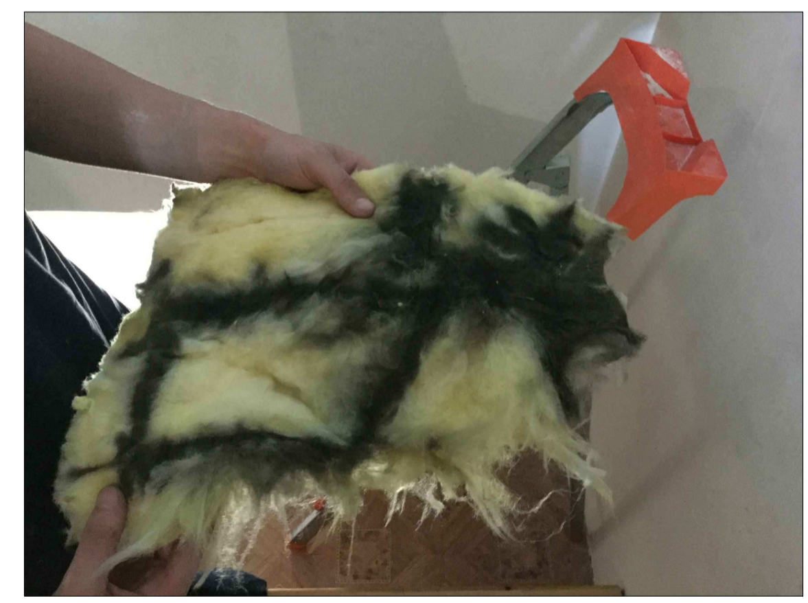
Наличие пылеватых отложений в утеплителе.
