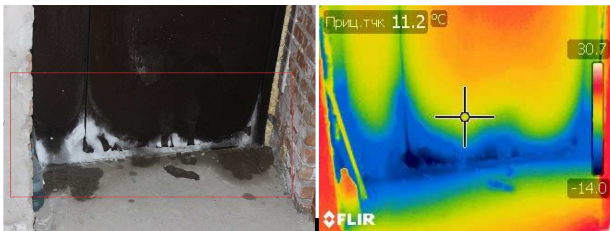
Рисунок 3.4.3 - Теплопотери в пороге уличной двери (лед под входной дверью)
