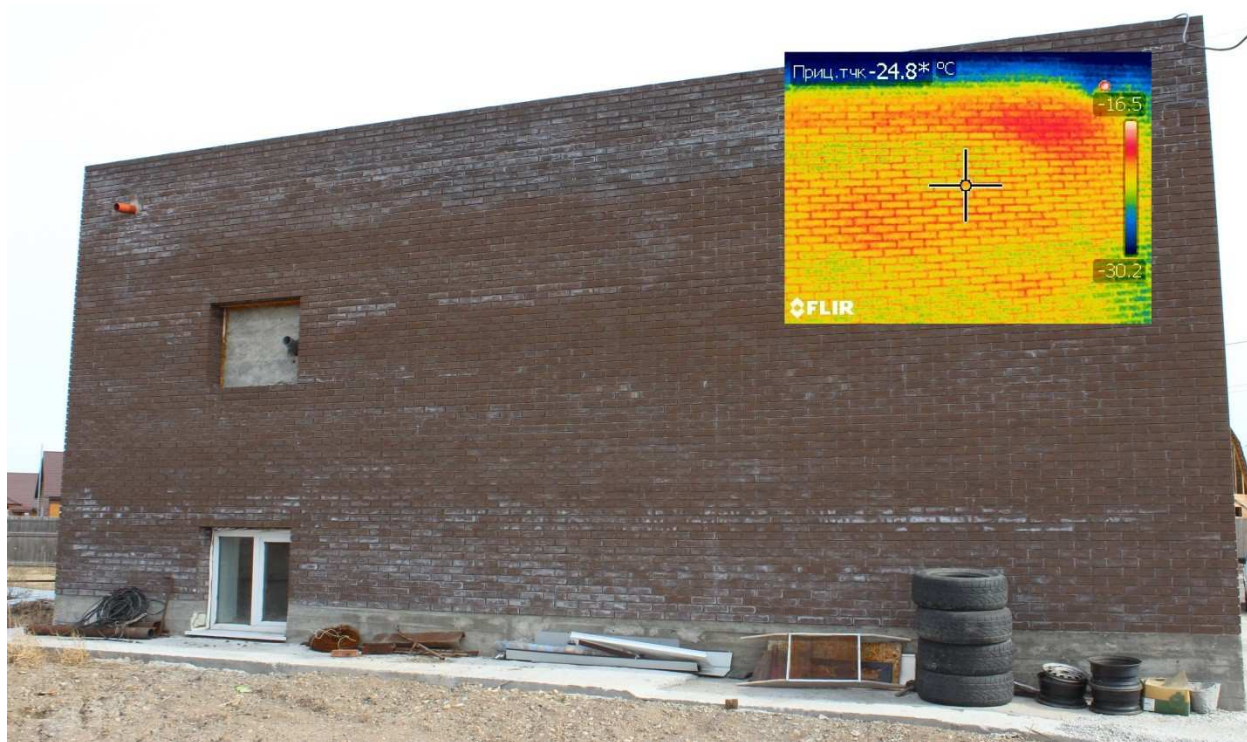
Рисунок 3.4.13 – Теплотери в уровне покрытия западного торца здания
