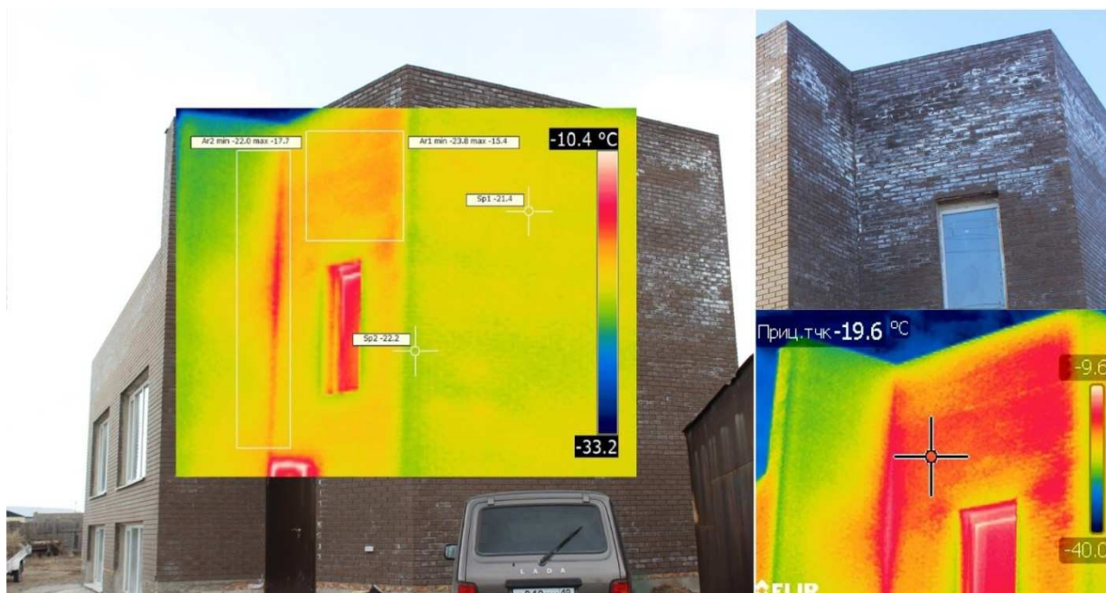
Рисунок 3.4.11 – Теплотери через угол сопряжения многослойных стен восточного торца здания, теплотери в месте интенсивных высолов
