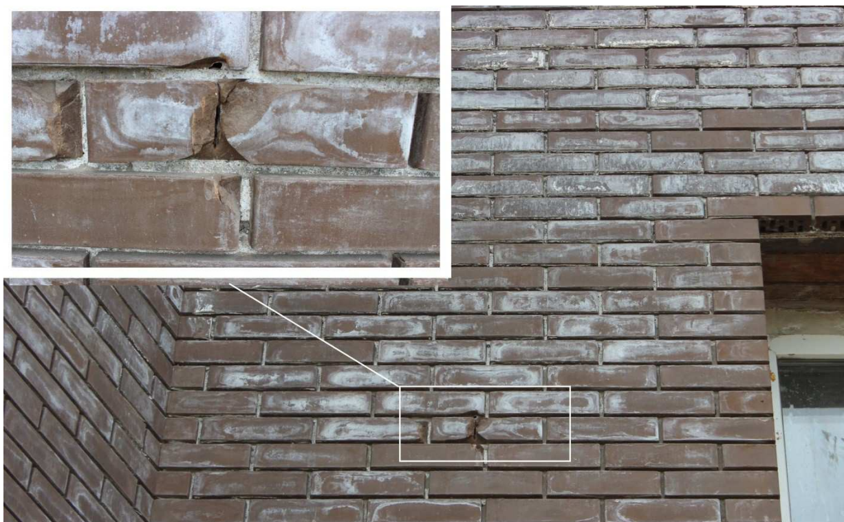
Рисунок 3.5.6 – Разрушение лицевого кирпича на восточном торце здания лаборатории
