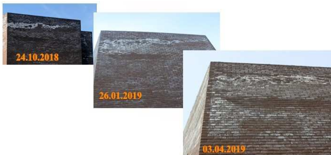
Рисунок 3.5.4 – Мониторинг за высолами на поверхности облицовочного кирпича здания лаборатории
