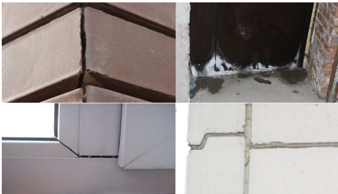
Рисунок 2.2 - Дефекты герметичности ограждающих конструкций
