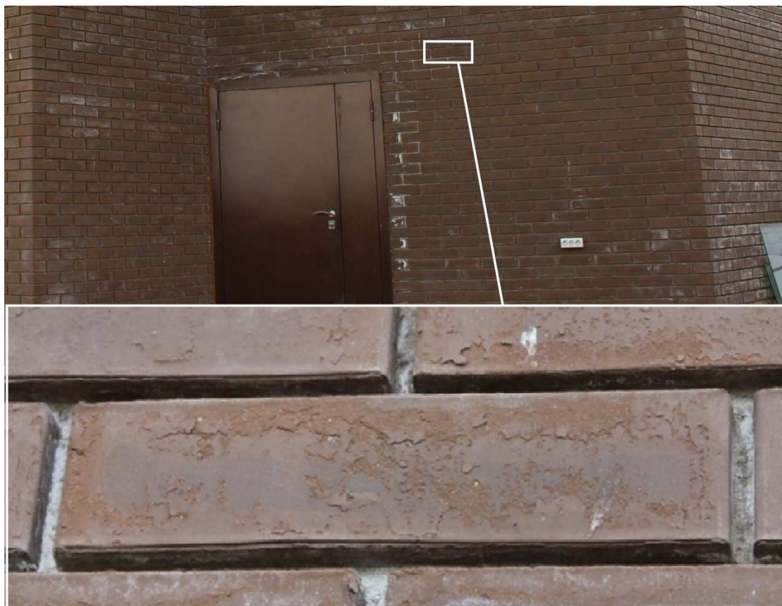
Рисунок 3.5.5 – Шелушения и отслоения поверхностного слоя лицевого кирпича
