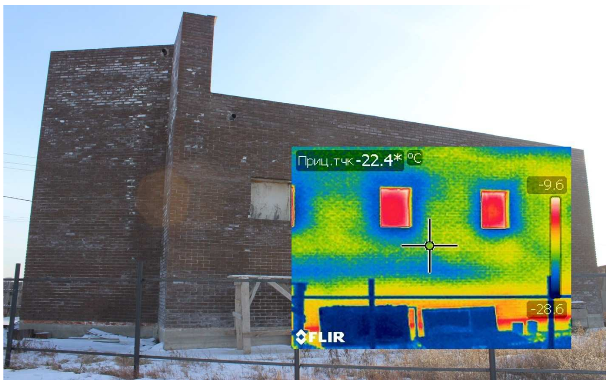
Рисунок 3.4.12 – Теплотери через невыполненные окна торца с северной стороны здания лаборатории
