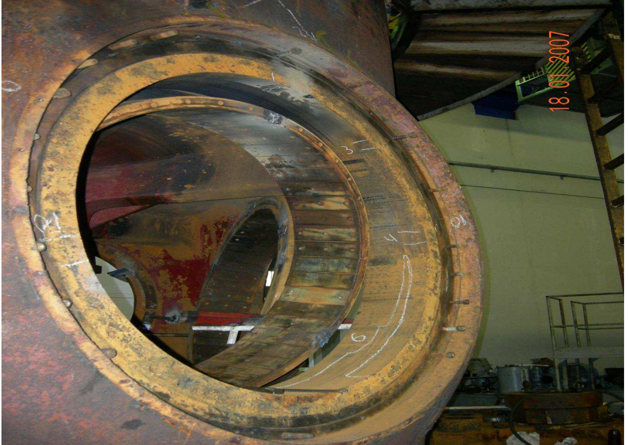
Рисунок 47– Повреждение бронзофторопластового подшипника РК ст. №16
