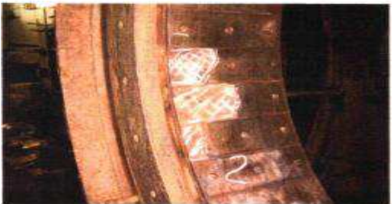
Рисунок 48– Повреждение бронзофторопластовой поверхности сегментов подшипника РК ст. №16
