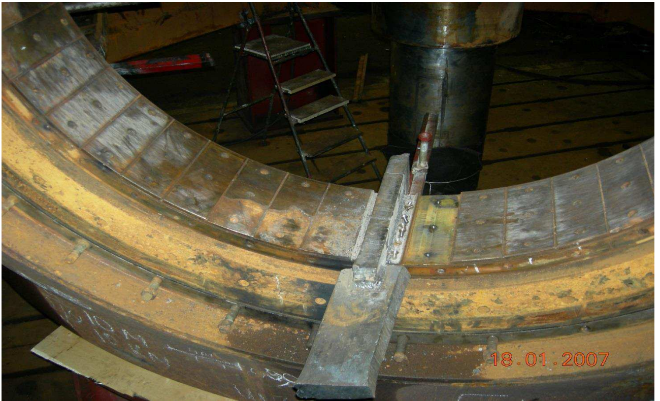
Рисунок 49– Повреждение крепления сегментов подшипника РК ст. №16
