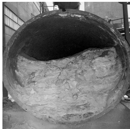
Рис. 1. Отложения пыли в межкорпусном газоходе
